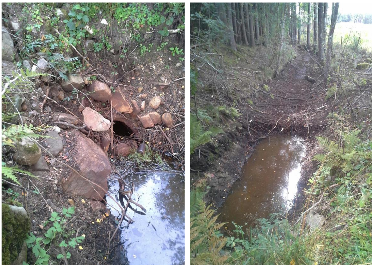
Figur 2: Exempel på nyligen (2014) framgrävd trumma och sektion av kanalen som haft mycket begränsad kapacitet under en längre tid. Båda bilder tagna i de övre delarna av kanalen.
